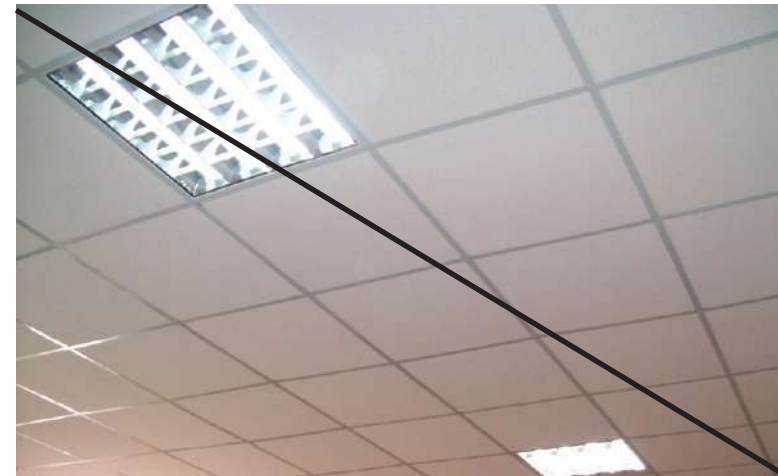
Плохо Открытые направляющие
